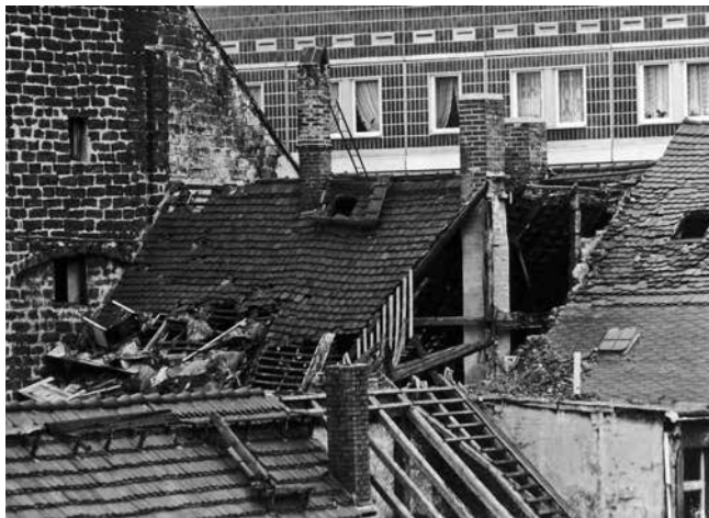
Licht und Schatten in der Schäferstraße 1986. Obwohl sich einige Häuser in einem baufälligen Zustand befinden, boten sie noch ein Dach über dem Kopf. Deshalb schrieben einige Friedrichstädter an ihre Haustüren: „Nicht plündern – Haus ist noch bewohnt!“ Foto: Edith Pufe
